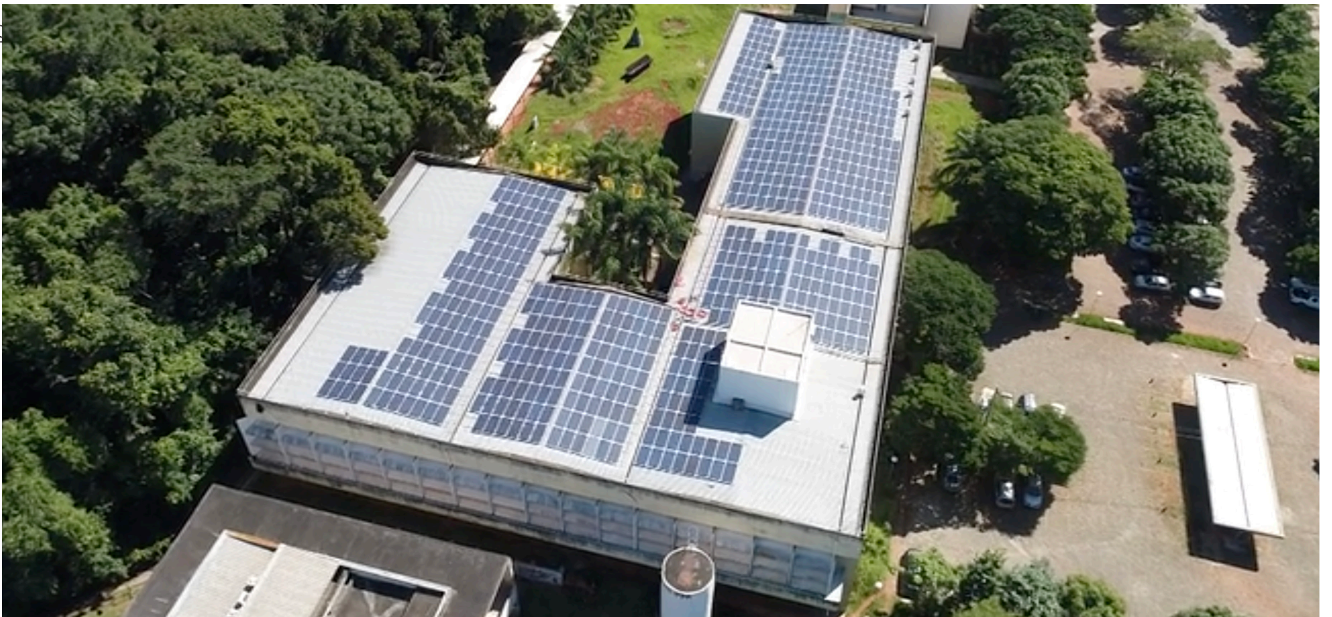
Telhado da biblioteca central é um dos três com a usina instalada no campus samambaia
